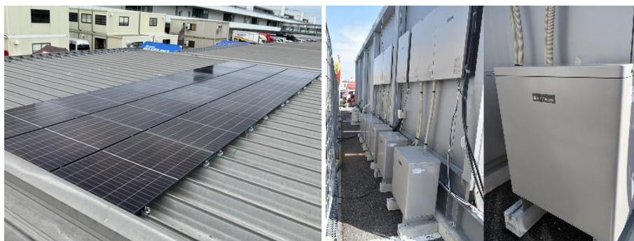
左：総発電容量 18.2kW の太陽光パネルを設置／右：出力 6kW、容量 12.8kWh の家庭用蓄電池を 3 基設置
