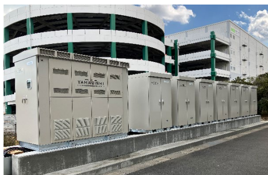
川崎工場に設置した
