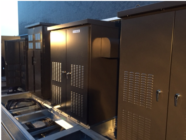
大型蓄電システム
